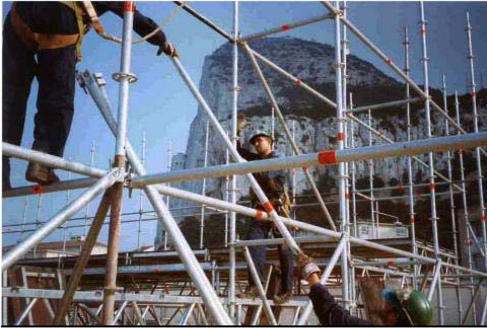
Ejemplo de una instalación de PROYESUR.
